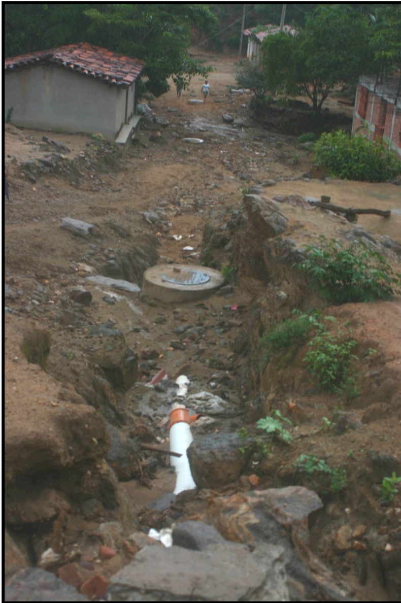
Figura 9. Obra de drenaje inconclusa en visita de inspección de la Comisión de Salud de la CRAC, Cuanacaxtitlán, San Luis Acatlán, Guerrero, 2010.
